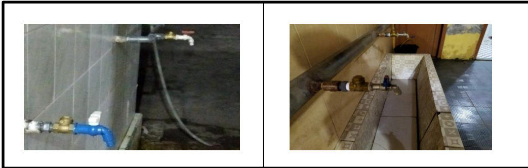
Gambar 2. Skema Pemasangan Katup Jenis Swing Check Tempat Wudu Masjid Babul Magfirah Desa Tanjung Selamat Kabupaten Aceh Besar.
