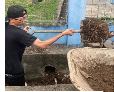
Gambar 4 Drainase Yang Tersumbat
