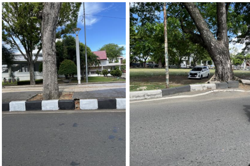
Gambar 1. Kondisi perkerasan di kawasan Taman Sari
