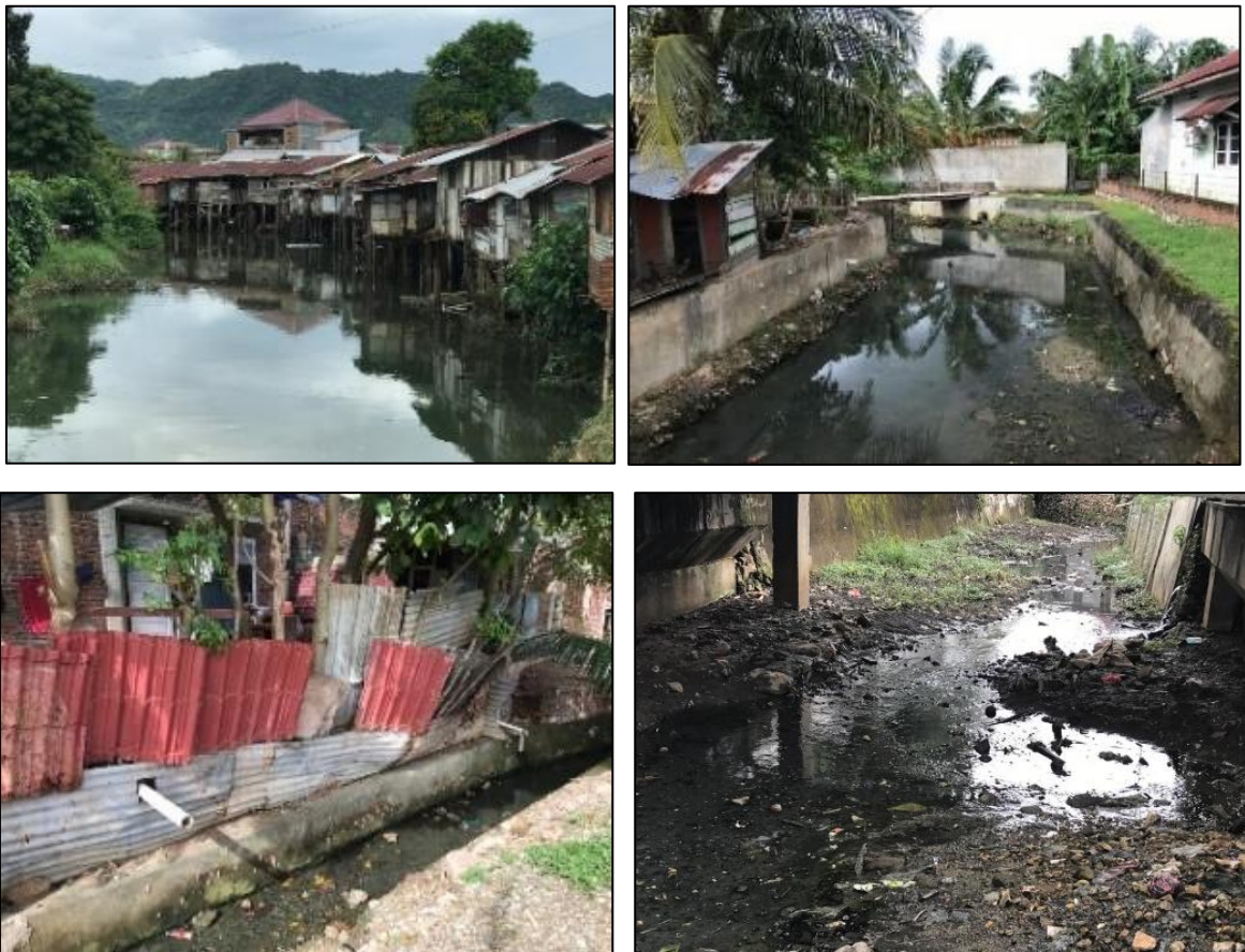
Gambar 1. Kondisi Drainase Gampong Garot, Kecamatan Darul Imarah, Kabupaten Aceh Besar (Dokumentasi Pribadi, 2022)
