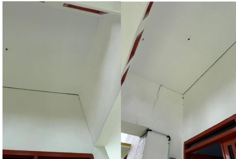
Gambar 2. Retak diagonal pada dinding pasangan bata akibat indikasi penurunan diferensial pondasi (bukaan retak \pm 2-5 mm) (sumber: dokumen pribadi, 2023)
