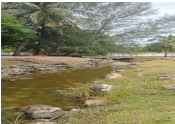
Gambar 6. Dinding kanal mengalami kerusakan (Dok. Penulis 7 Juni 2022)
